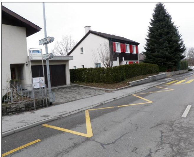
Abb. 8: Strassenzustand Restfläche Bushaltestelle Ruopigen Schulhaus
